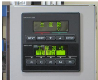
電源投入時パネル表示
