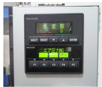
エア圧異常表示
